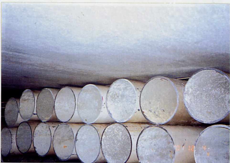
23年経過の冷却水配管 アリオレス効果により 全く錆の形跡が見られない
